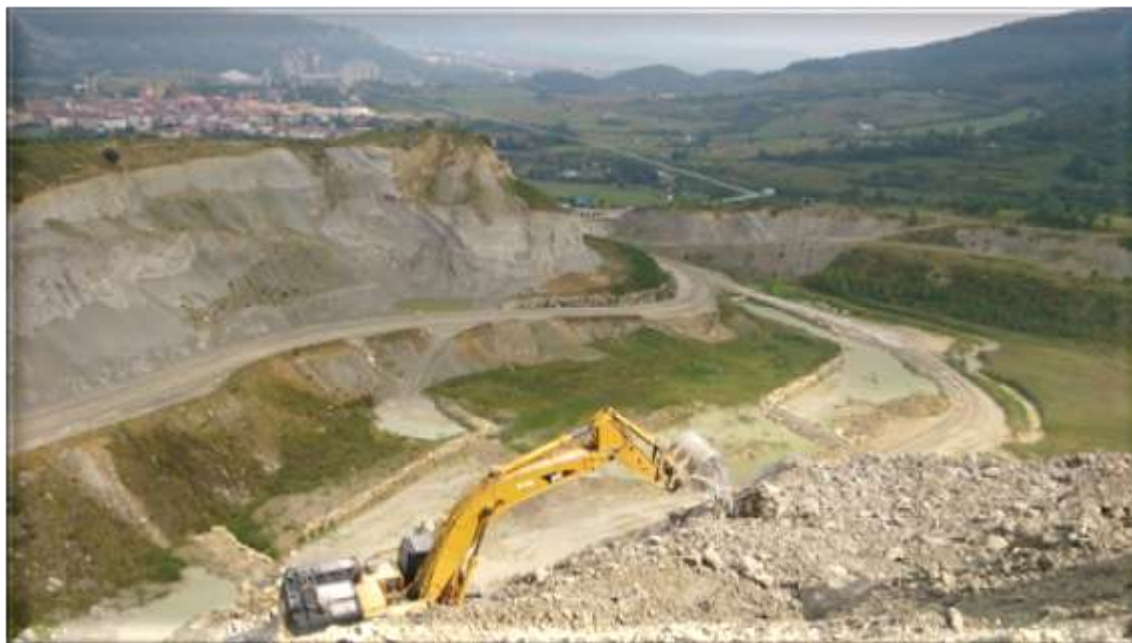
Panorámica de la cantera de Eguíbil, en que se aprecian diferentes zonas ya verdes en vías de restauración
